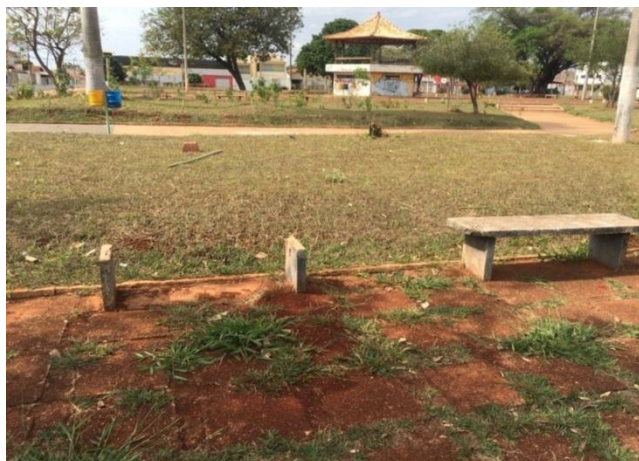
Figura 37 – Canteiro elevado e banco danificado
