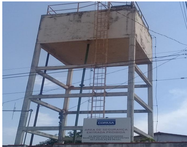
Figura 8 – Reservatório elevado do Bairro Mato Grosso
