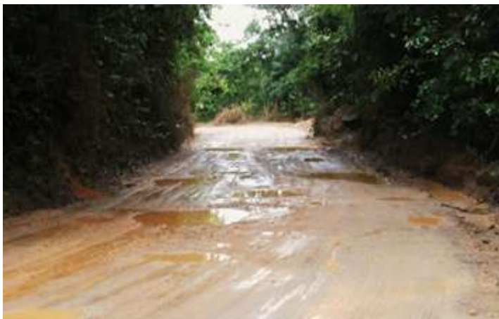
Figura 4 - Defeito: seção transversal inadequada
