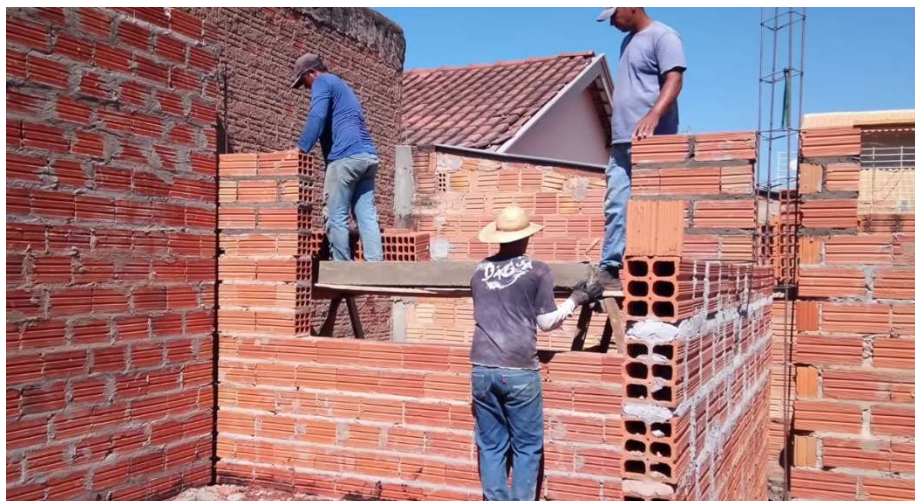
Figura 10 – Pedreiros e serventes sem a utilização de EPIs necessários
