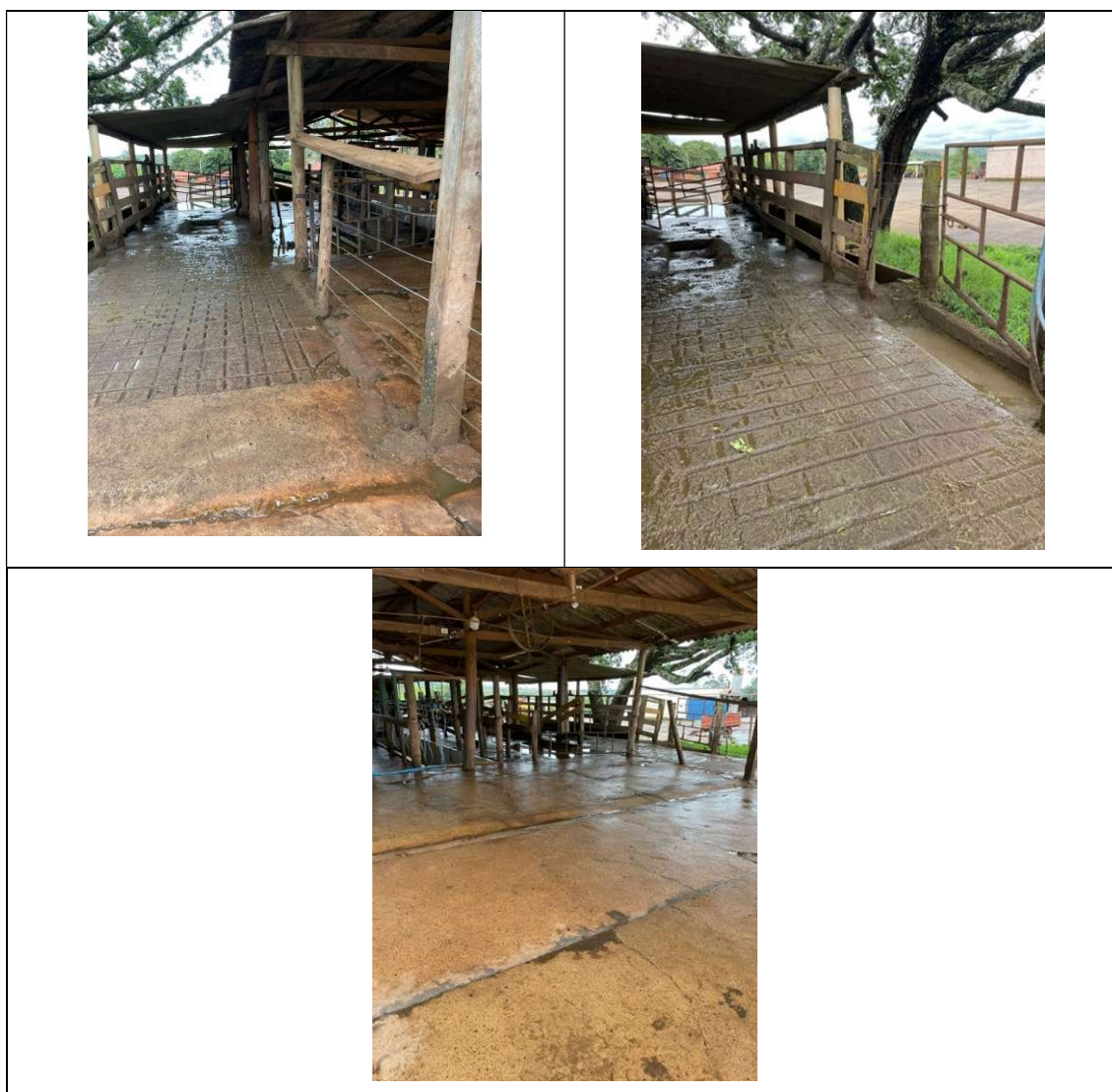
Figura 3. Presença de valas em locais de trânsito de animais.
