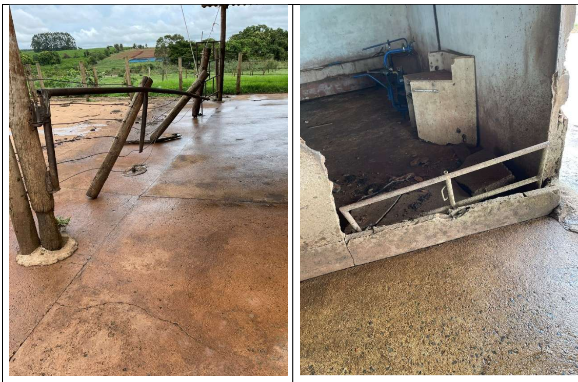
Figura 4. Madeiramento danificado e presença de material pontiagudo exposto.
