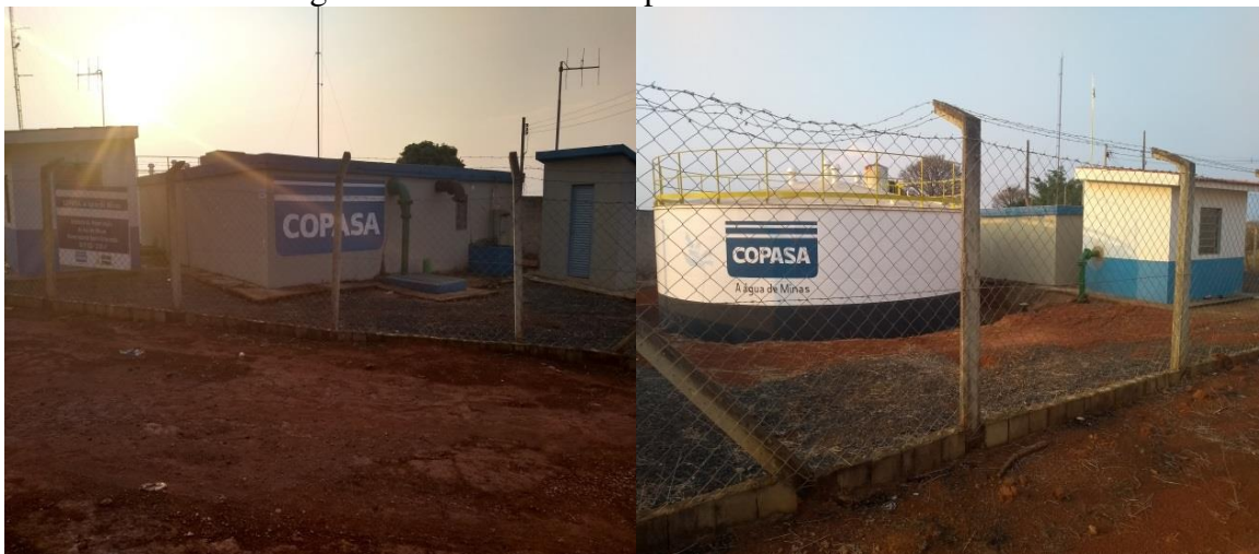
Figura 7 - Reservatórios apoiados de 200 m 3 cada.
