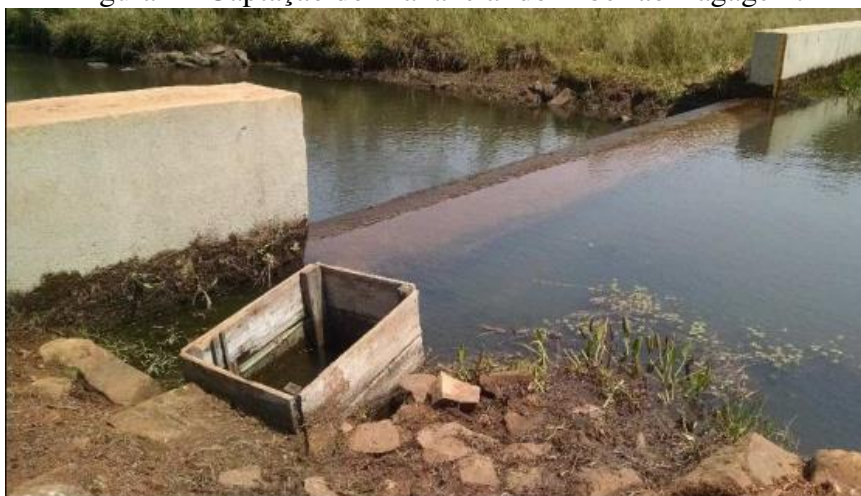
Figura 2 - Captação do Manancial do Ribeirão Bagagem.
