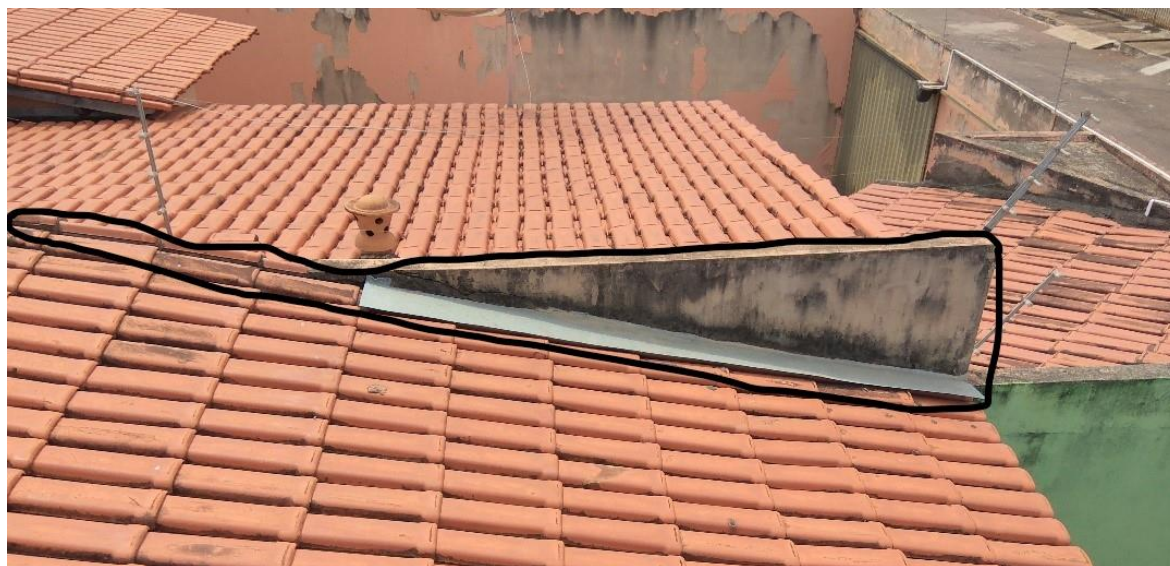
Figura 34 - Rufo inadequado, manchas escuras e estado precário da pintura do muro.
