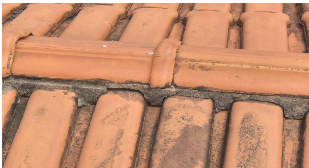
Figura 25 - Desprendimento da argamassa do emboço.
