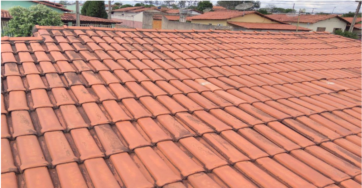
Figura 21 – Telhado com diversas telhas escurecidas.
