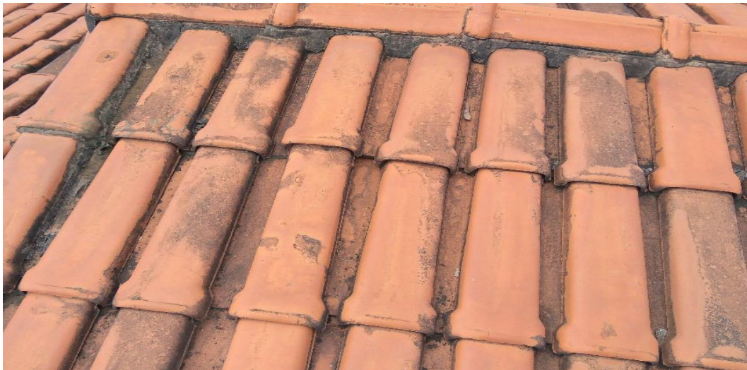
Figura 20 - Telhas escurecidas e emboçamento incorreto.
