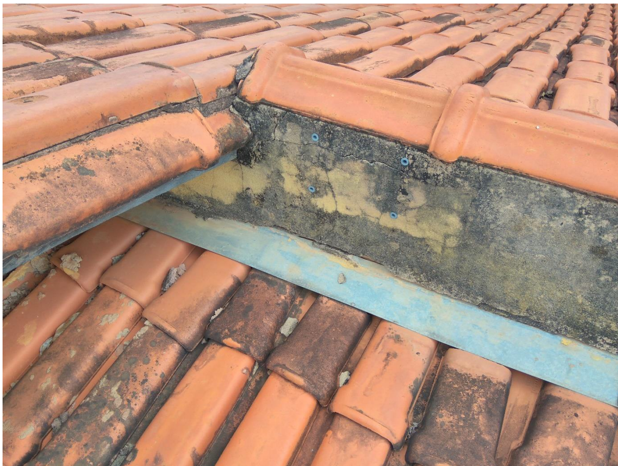
Figura 36 - Fissuras, manchas escuras, argamassa e rufo se soltando da parede.
