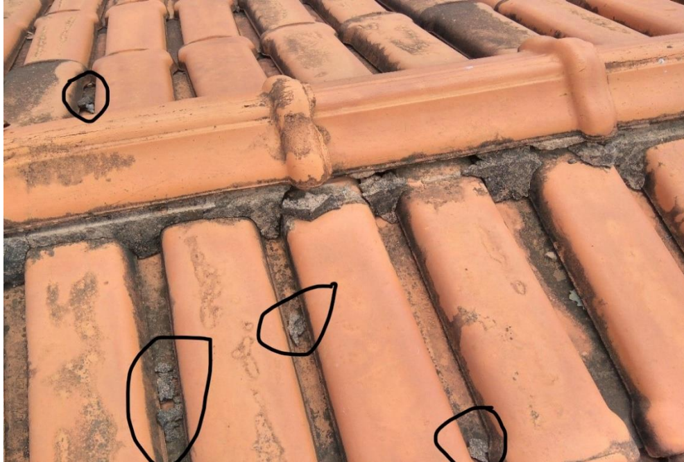
Figura 26 - Pedacos de argamassa acumulados.
