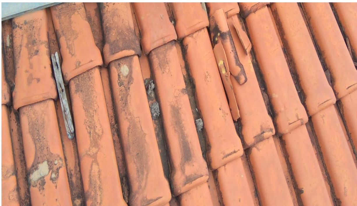
Figura 32 - Materiais sobre o telhado e telhas com manchas escuras.
