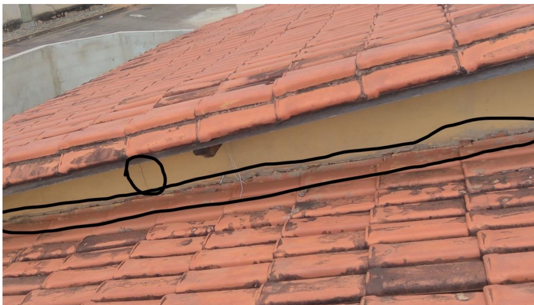
Figura 38 - Fissura e deterioração da ligação entre telhado e parede.
