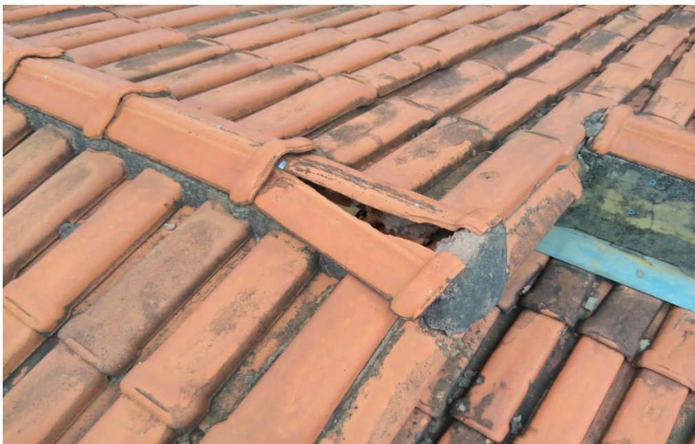
Figura 22 - Cumeeira quebrada, manchas escuras e emboçamento incorreto.
