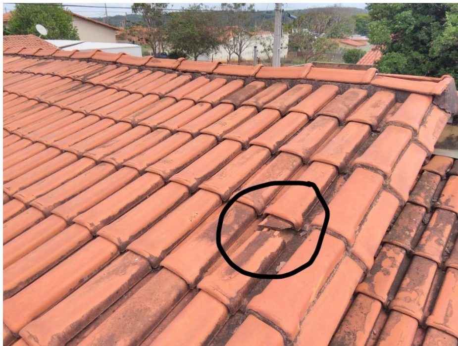
Figura 31 - Telha quebrada e algumas com manchas escuras.
