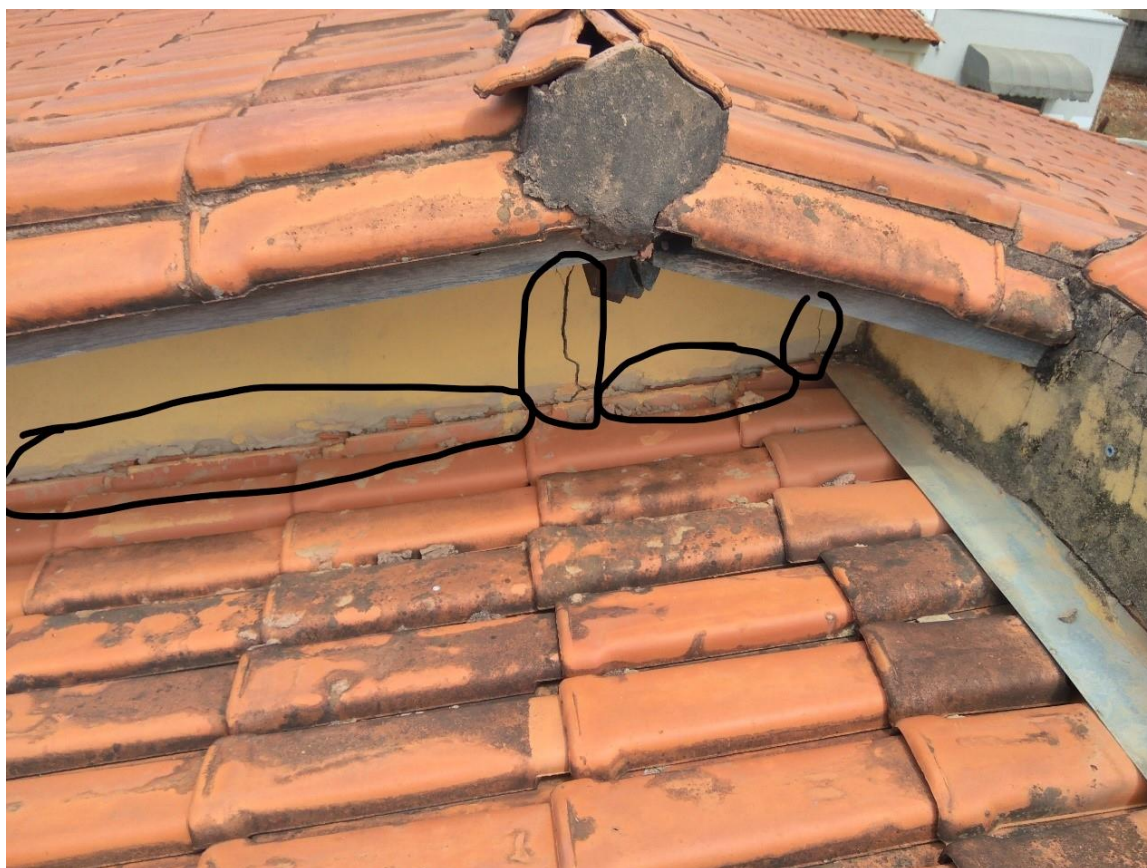
Figura 37 - Fissuras e ligação deteriorada entre o telhado e a parede.
