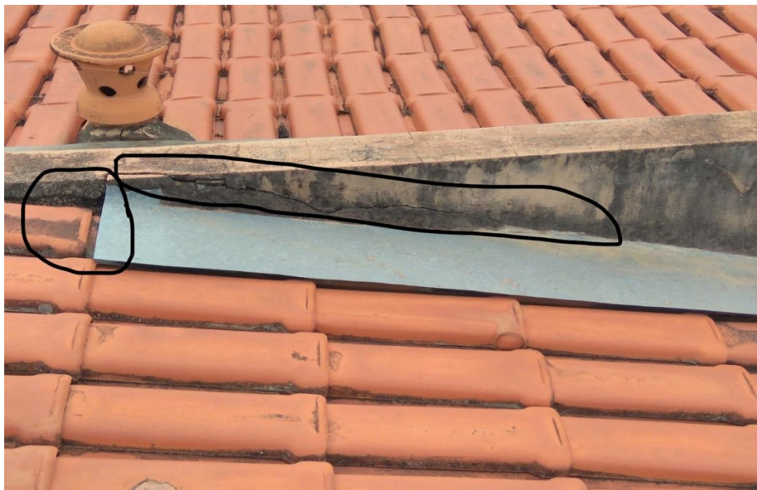
Figura 33 - Fissura e chapa metálica inadequada.
