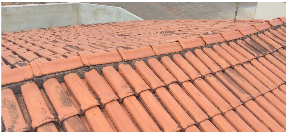
Figura 27 - Fissuração e desprendimento do emboço em toda a extensão das cumeeiras.
