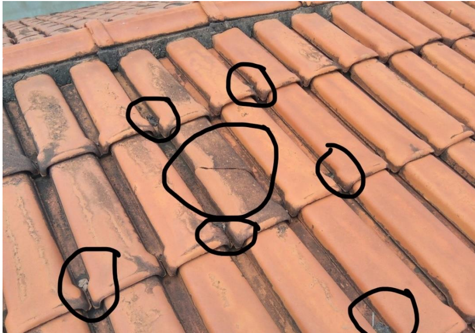
Figura 29 - Telha quebrada e pedaços de argamassa.
