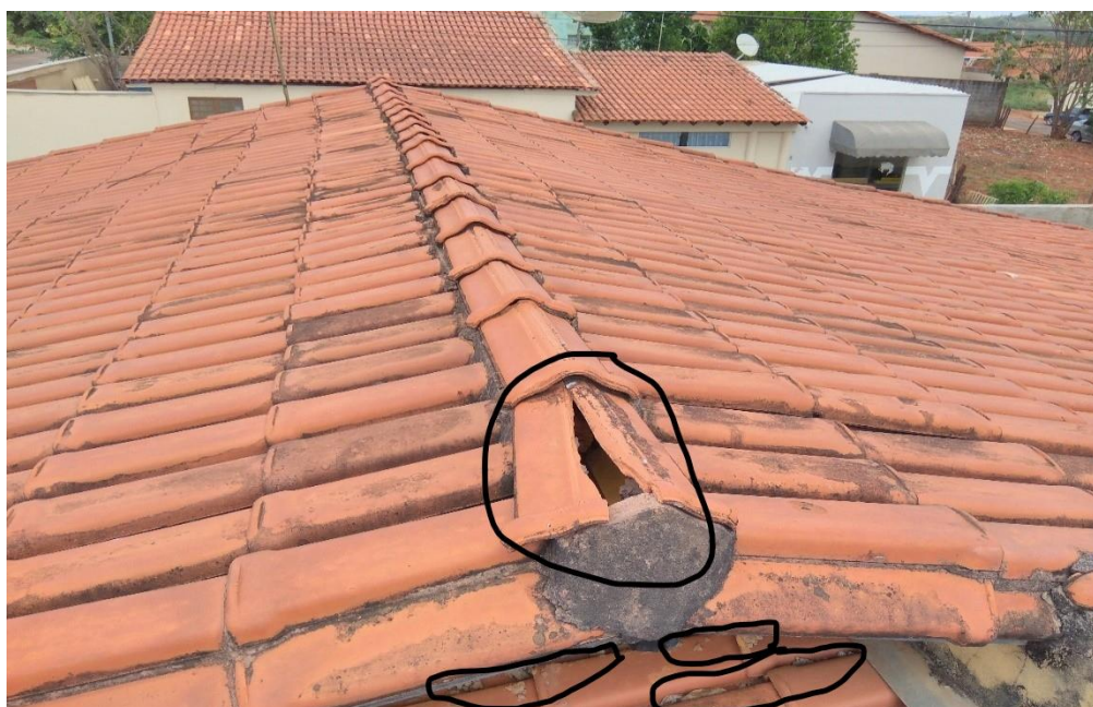
Figura 23 - Cumeeira quebrada e detritos.
