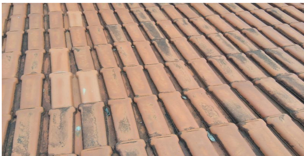
Figura 18 - Manchas escuras nas telhas.
