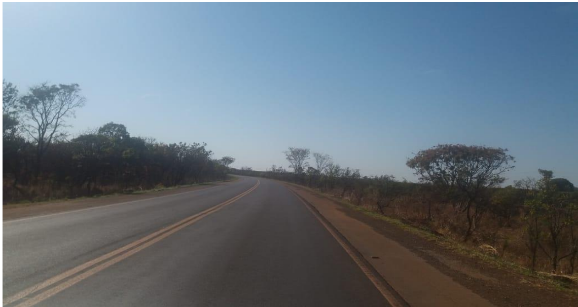
Figura 08 – Asfalto com sinais de desgaste
