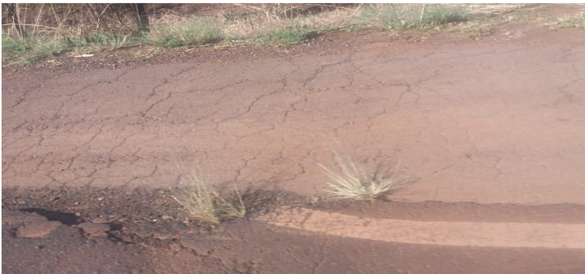
Figura 12 – Trecho observado com trincas
