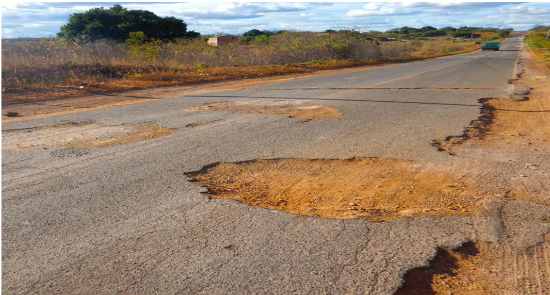
Figura 5- Trecho de rodovia com buracos e afundamentos.
