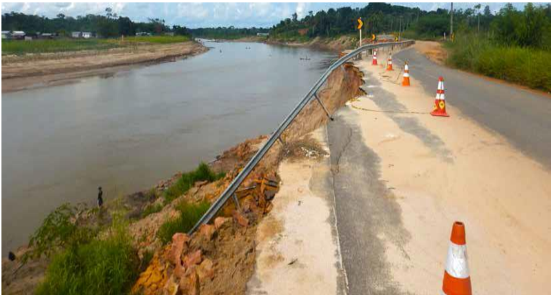
Figura 7- Trecho de rodovia com queda de barreira.
