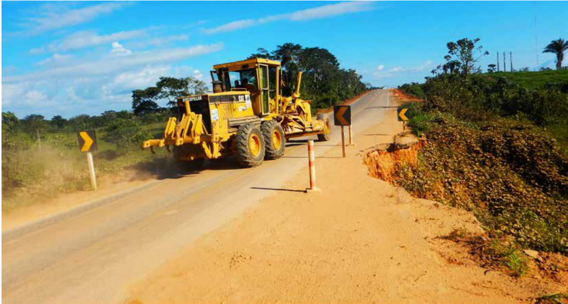
Figura 6- Trecho de rodovia com desmoronamento.
