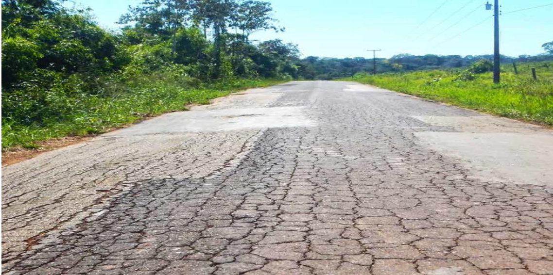
Figura 3- Trecho de rodovia com trincas tipo ‘couro-de-jacaré’.
