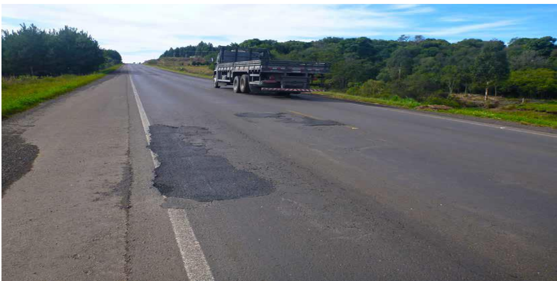
Figura 4- Trecho de rodovia com remendos.
