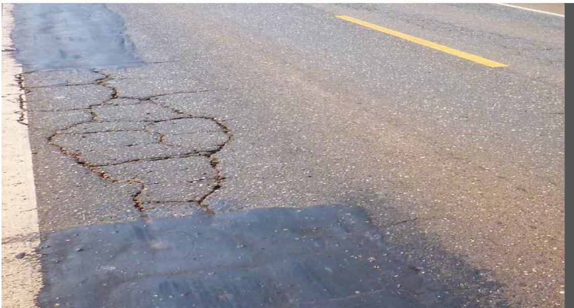
Figura 2- Trecho de rodovia com afundamento, remendo e trinca.
