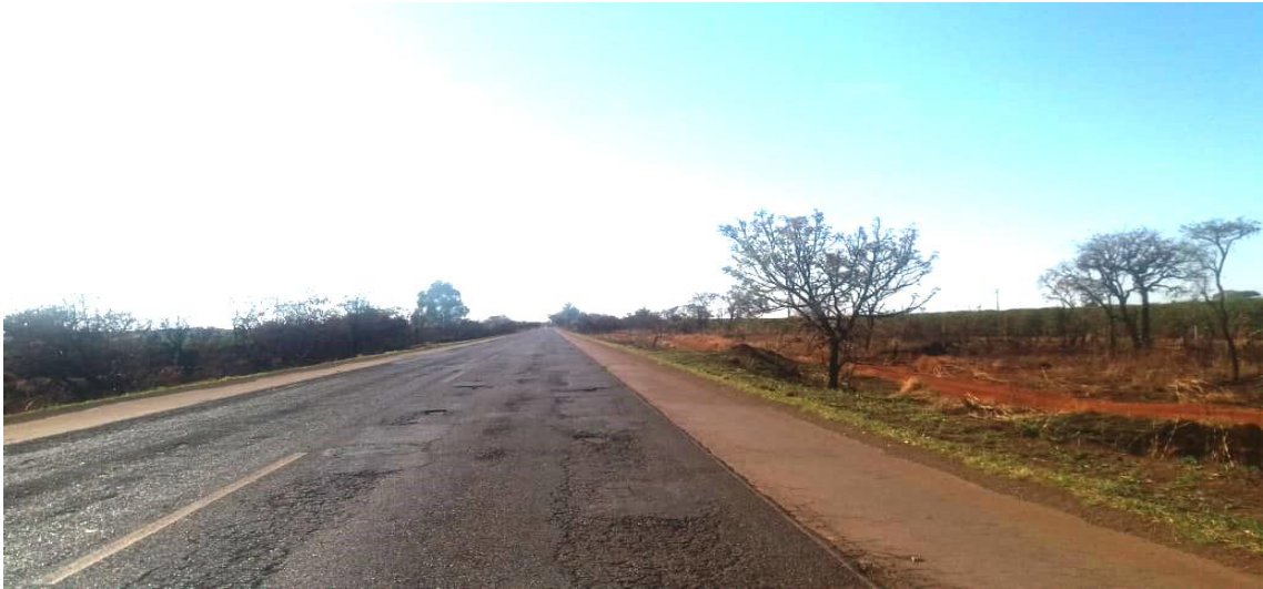
Figura 11 – Afundamento e Remendos na via
