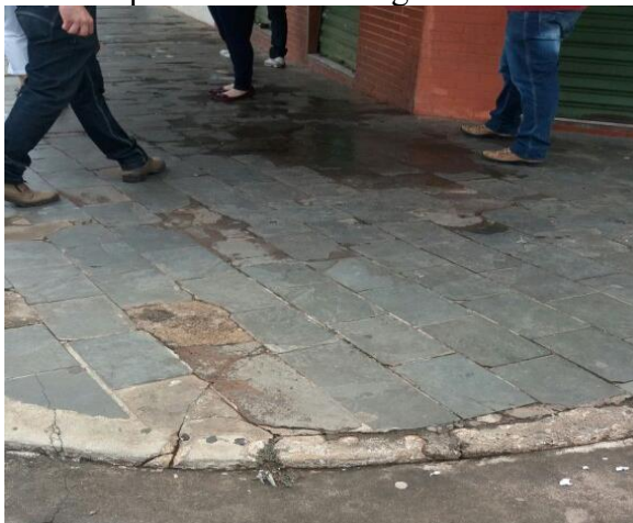
Figura 8 b - Ausência de Rampa na Avenida Olegário Maciel / Avenida Belo Horizonte
