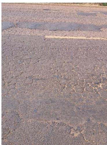
Figura 2 - Trincas tipo couro de jacaré
