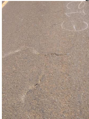
Figura 1 - Trincas transversais e longitudinais curtas
